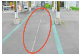
通路に埋め込んだ導線
