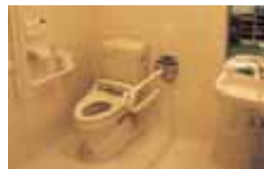
車いす対応のトイレ
