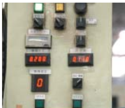
製造設備の制御盤。赤い数字のカウンターで製造個数が示される。
