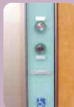
エレベーターには点字シールを貼っている。
