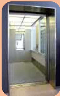
エレベーター内にはガラス張りで車椅子利用者が乗ったままの位置で降りる階を確認できるように工夫されている（工場事務棟内）。
